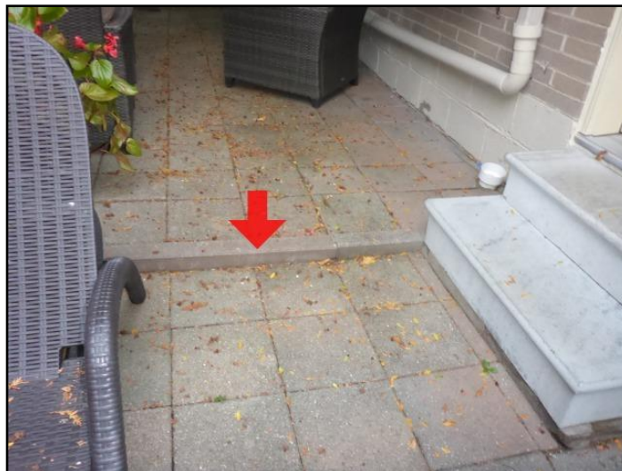
Uneven (trip hazard)
