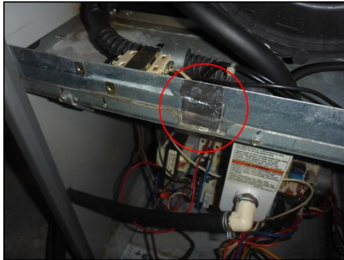
Blower door switch taped over
